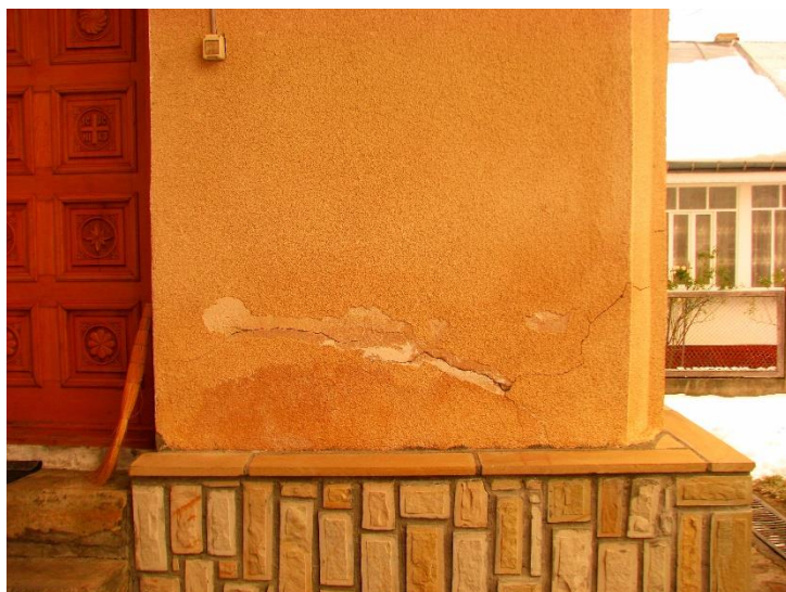
Detaliu acces exterior Diaconicon- Zona cu degradari
