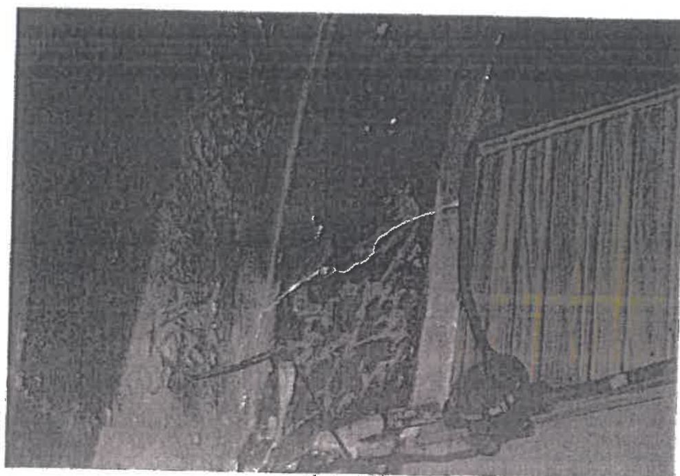
Foto 13.3 Fisuri orizontale la nivelul spaleților de zidărie
